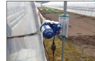
(自動換気装置 WIND-UP)
