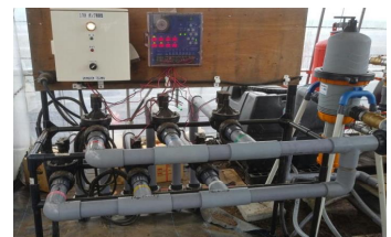
導入された自動灌水設備
