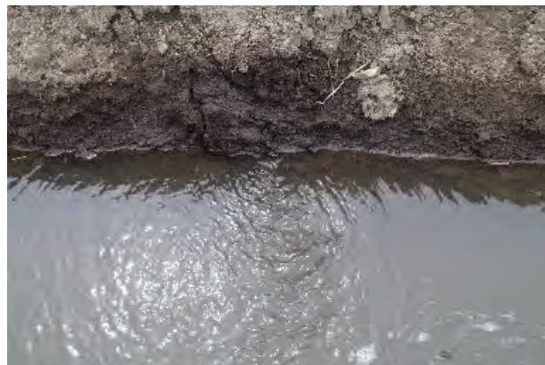
●古暗きよからの漏水
