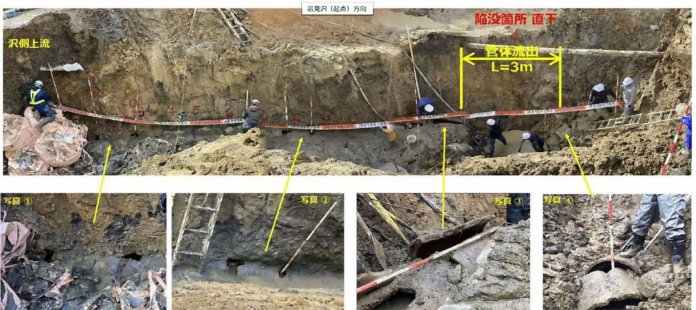
図2-3 横断管の管体流出部、頂部・継手部の損傷状況
