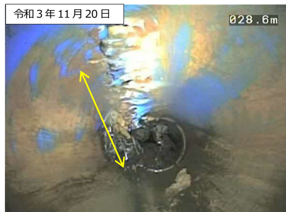
図 2-16 水抜き管 A 吐口より撮影した 28.6m から 28.8m 間の損傷状況〔黄矢印間〕
