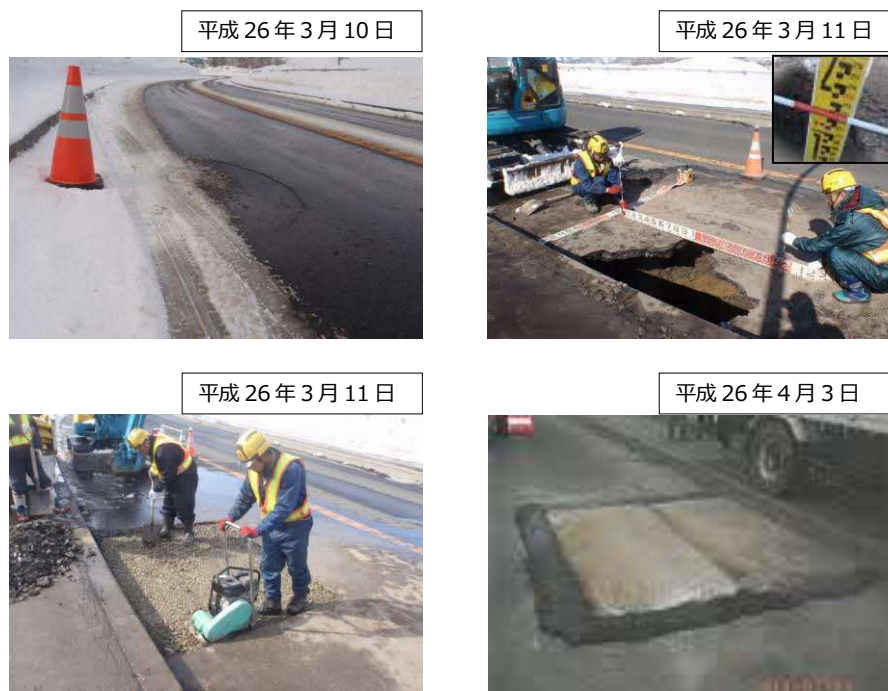
図1-12 確認された路面沈下と対応措置状況
