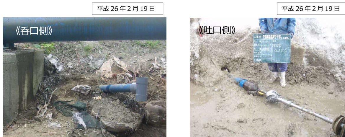
図 1-10 R 側盛土法尻の滞水解消を目的とした水抜き管 A の施工状況
