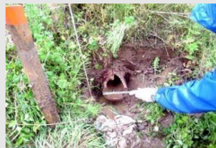
写真25 壊れた排水口 (中央農試提供)
