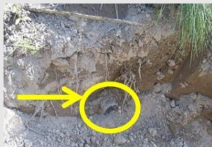
写真24 埋もれた排水口 (中央農試提供)
