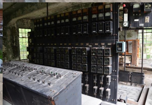
幌内発電所内部の様子
