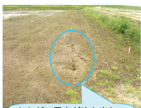
かんがい用水が吹き出し、穴が開いてしまいました。
