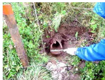
旧暗渠からの漏水
