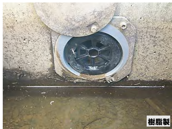
流入口埋め込み式（スクリーン）
