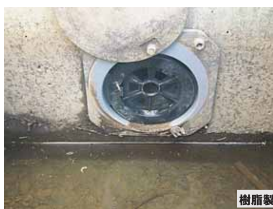
流入口埋め込み式（スクリーン）
