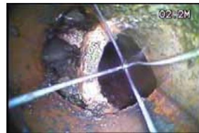
写真-1 暗渠管のずれ （④AS 圃場吸水渠）
