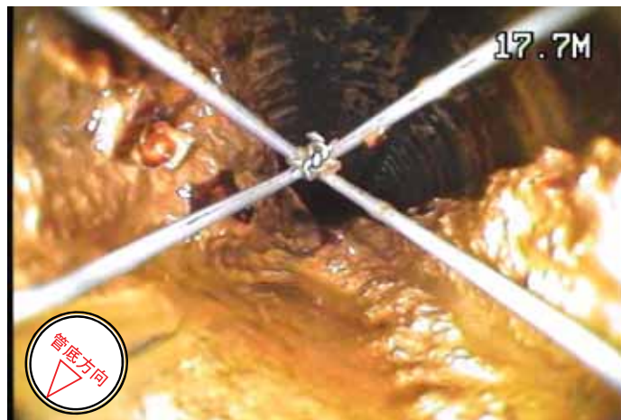
暗渠管内の土砂堆積状況
