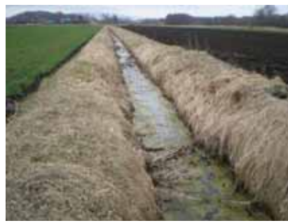
写真.排水路の水没
