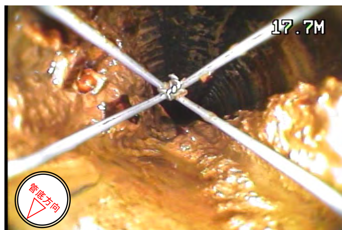
暗渠管内の土砂堆積状況
