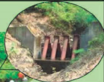
流木等を捕捉する 治山ダム(スリットダム)
