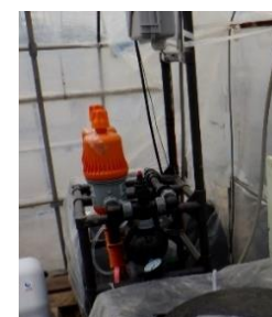
写真2 ミニシステム
