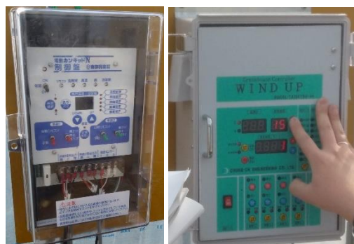
写真1 各自動巻き上げ機器の制御盤 (左：電動カンキットN、右：WIND-UP)
