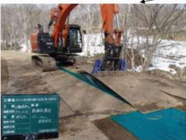
【工事用道路への敷鉄板敷設状況】 工事用車両の走行による、土ぼこり等の周辺への飛散等を防止するために、施工後速やかに敷設を実施
