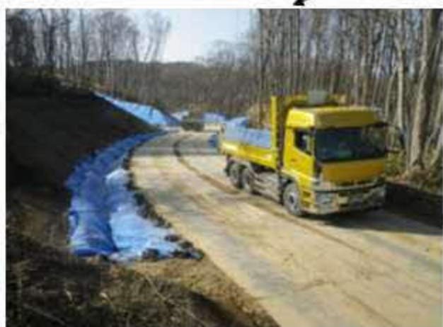
【工事用道路、工事用車両の走行状況】 雪解けや降雨による排水等の対策としてビニルシートによる側溝等を整備し、周辺への無計画な濁水流出等を防止 また、切土法面（写真奥）には施工後速やかにビニルシートを貼り、土ぼこり等の飛散を防止
