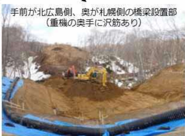
【3号橋、橋台設置部分の掘削状況】 施工範囲以外の立木伐採等を最小化しているほか、施工範囲周辺の整理を徹底。 写真手前の黒いパイプは雨水等を流下させるためのフレキシブルパイプで掘削範囲の土砂流入を防止している
