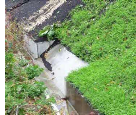
(設置例) 道道奥尻島線
